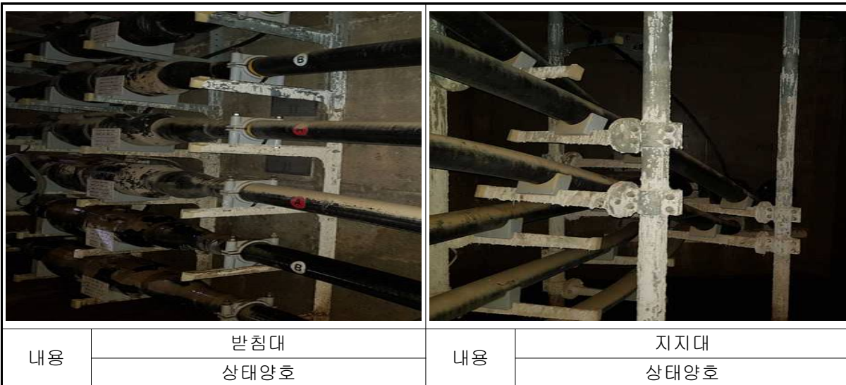
【사진 5.4】 부속 및 부대설비 현황
